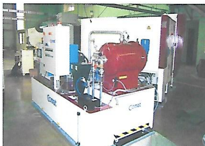
Installation pouvant gérer jusqu'à 180 litres/min soit 2 machines de taille ou 3 d'affûtage (Photo fournie par Comat)
