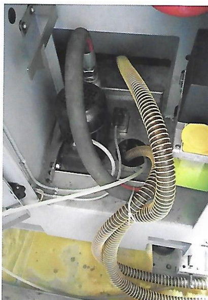
Bac standard de capacité insuffisante au regard du débit de la pompe et du fonctionnement même de la machine
