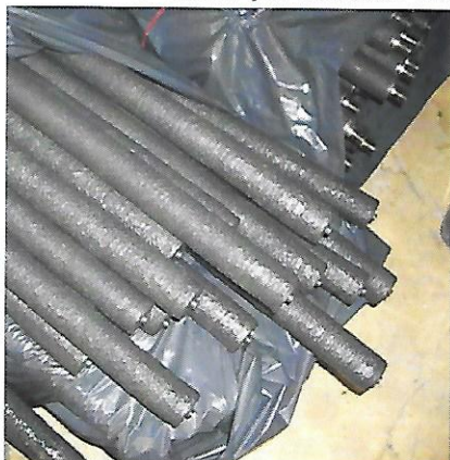
Bougies d'un filtre à fentes endommagées par un mixte de matière acier et carbure et un débit de filtration de 60 l/min pour un arrosage de 120 litres/min
